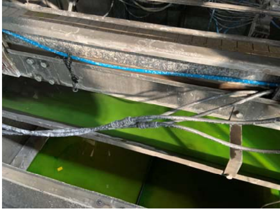
流失液体收集设施
