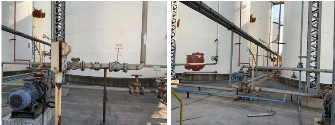
储罐及标识牌
